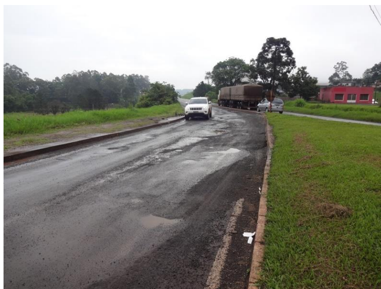
Figura 4: Trevo de acesso a Pinhalzinho (km 581)- Afundamentos e recalques do pavimento
