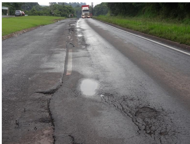
Figura 6: Nova Itaberaba - km 555,6 – Trincamento / desagregação e afundamento do pavimento
