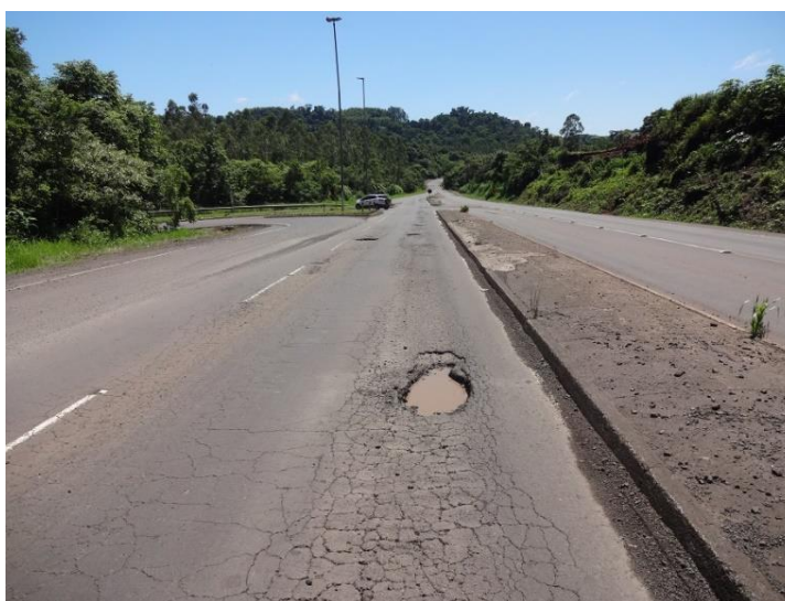
Figura 16: Acesso a Caibí - Buracos, trincamento e deformações do pavimento
