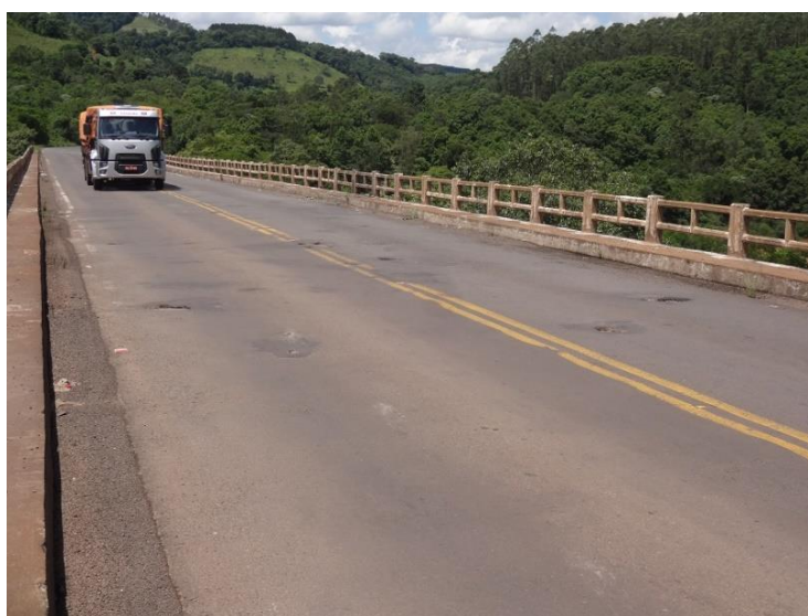
Figura 3: Situação da capa asfáltica na Ponte sobre o Rio das Antas (km 628,7)
