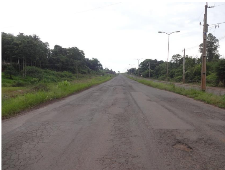
Figura 20: São José do Cedro (km 102,7)- Buracos, trincamento e deformações
