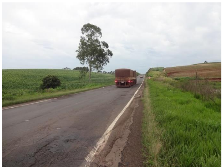
Figura 19: Km 117,6 - Desagregação e trincamento do pavimento
