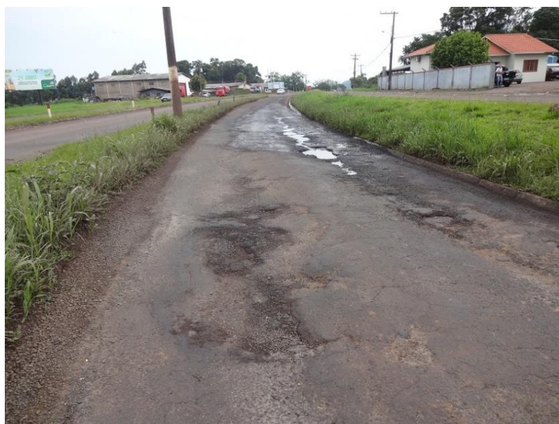
Figura 22: Guaraciaba (km 84,6)- Péssima situação do pavimento
