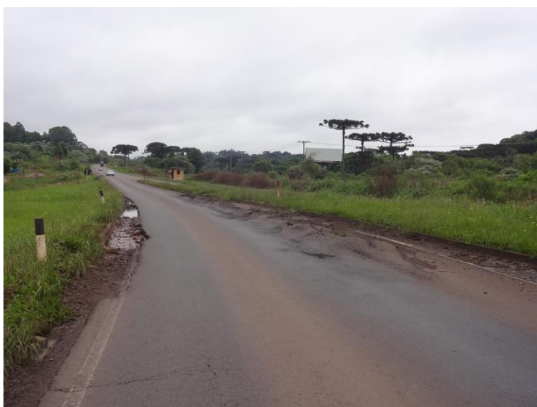
Figura 7: Km 515,3 - Afundamento e recalque do pavimento
