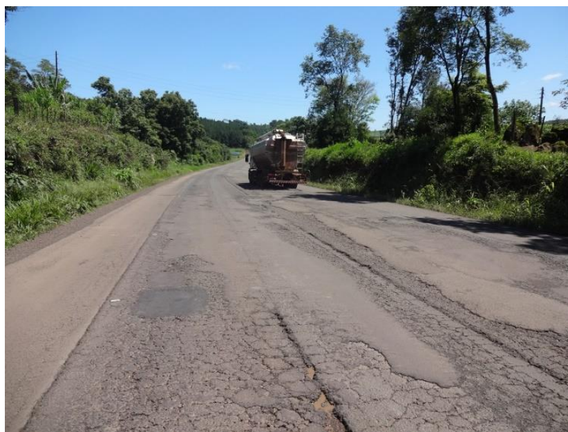
Figura 14: BR-158/SC , km 132,1 - Desagregação e trincamento do pavimento
