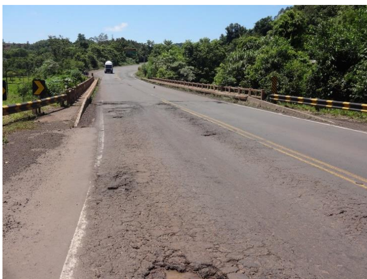
Figura 17: Ponte sobre o Rio São Domingos (km 134,3)- Buracos e afundamento do pavimento na cabeceira
