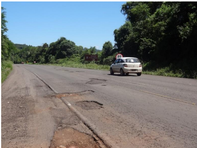
Figura 15: Km 132,8 - Situação do revestimento asfáltico da pista e do acostamento
