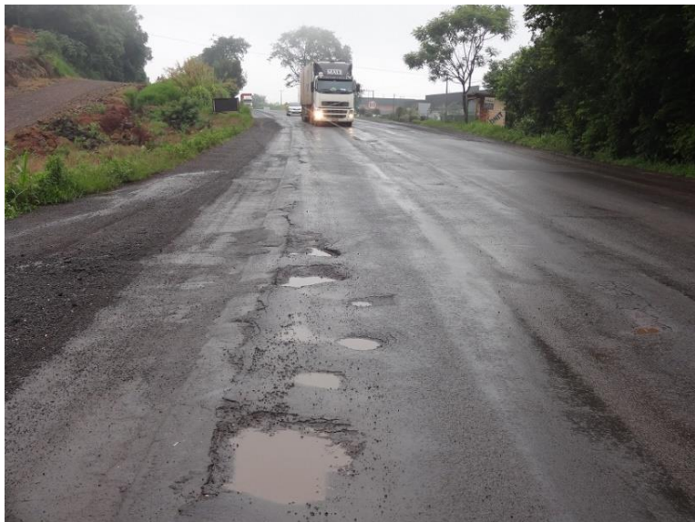
Figura 5: Km 579,8 (Pinhalzinho) - Situação do pavimento
