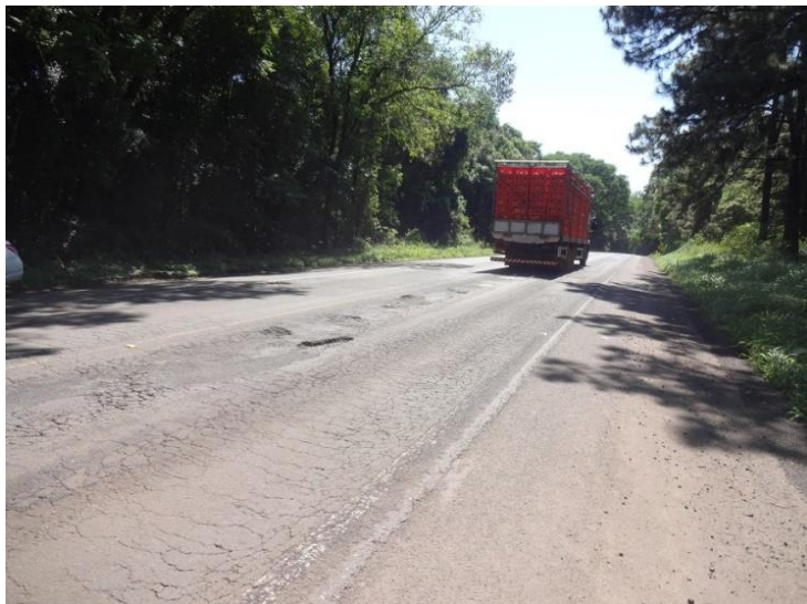
Figura 2: Km 594,5 - Trilha de roda e afundamento da pista
