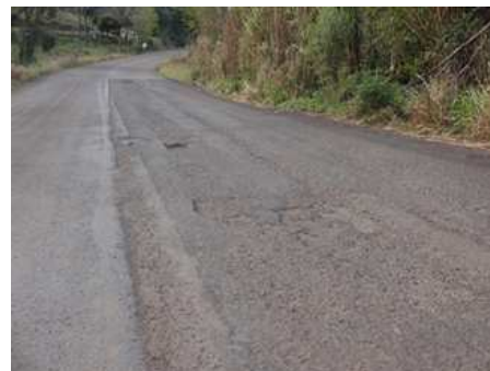
Buracos, afundamentos e recalques do pavimento - km 86
