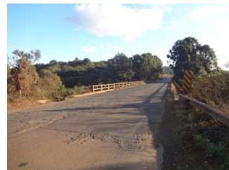
Km 11,80 - Situação da Ponte e do pavimento
