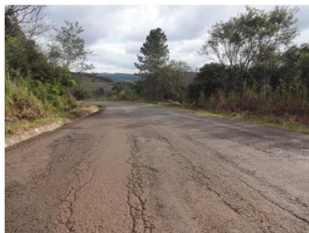
Situação do pavimento no km 14,5
