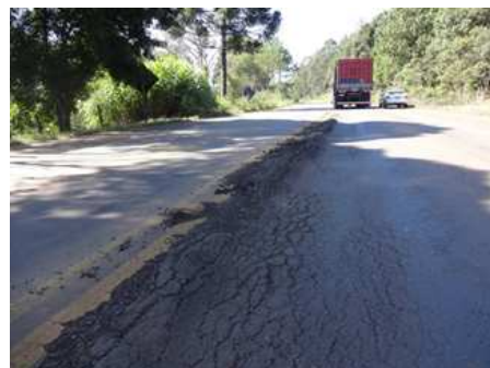
Km 178 – Afundamentos e recalques da pista
