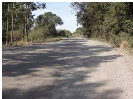
Escorregamento da pista- km 80,5
