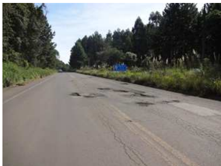
Km 20,6 – Buracos na pista
