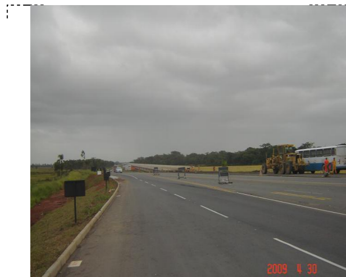
COMENTÁRIO: Serviços de terraplenagem nas cabeceiras do viaduto de transposição do banhado de Maracajá.
