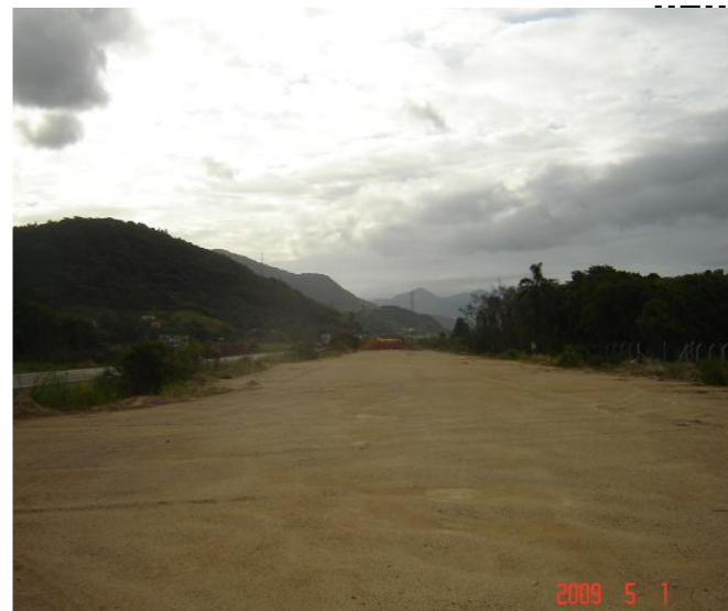
COMENTÁRIO: Trecho aterrado - cabeceira sul da ponte sobre o rio Araçatuba - aguardando o adensamento, visto características de suporte do sub- leito.
