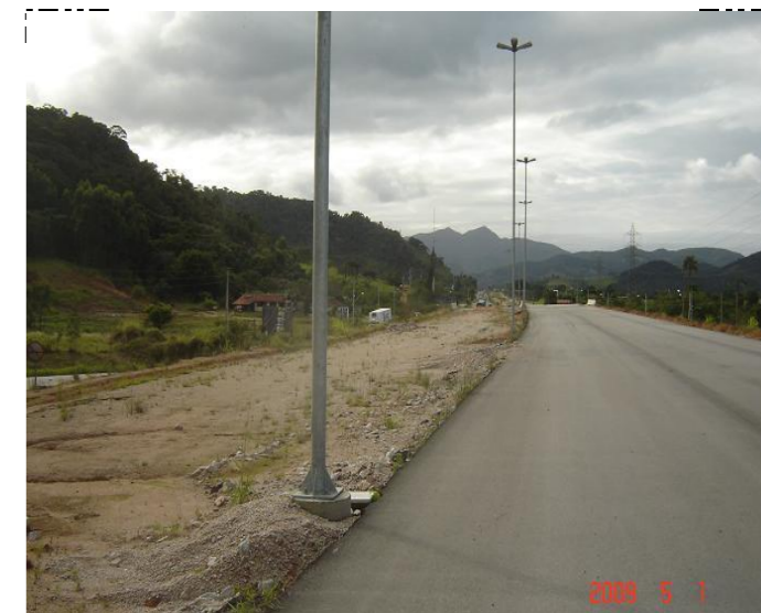
COMENTÁRIO: Ao fundo, a passagem inferior de acesso a Penha de Imbituba. Enquanto uma pista está com a capa asfáltica executada, a outra permanece sem base. Trânsito numa coletora somente.
