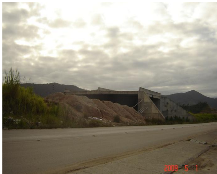
COMENTÁRIO: Outra vista da passagem inferior de acesso a localidade da Penha.
