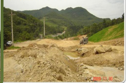
SUB TRECHO SUL DO ACESSO AO TÚNEL DO MORRO AGUDO - TERRAPLENAGEM EM EXECUÇÃO
