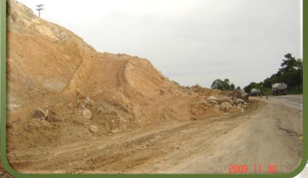
CORTE, COM INCIDÊNCIA DE ROCHA, PRÓXIMO AO TÚNEL DO MORRO DOS CAVALOS
